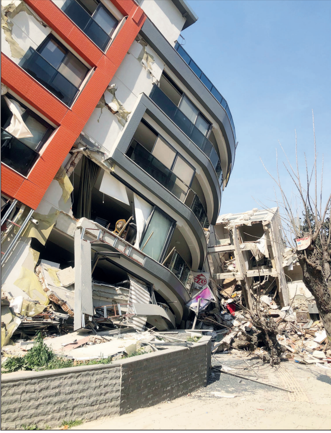
Şekil 1: Hatay'da depremden görüntü.
